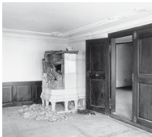
Links: Küche im Erdgeschoss vor der Gesamtrenovierung. Zustand Oktober 1998. Rechts: Saal im 1. Obergeschoss. Zustand nach der Beschädigung des um 1790 entstandenen Kachelofens durch Vandalen. Zustand Oktober 1998. KDP Fotoarchiv.
