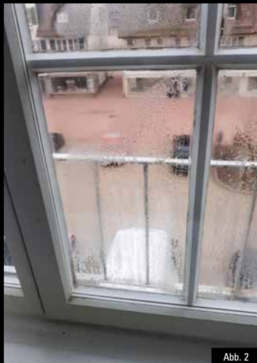
Abb. 2: Der Einbau einer Isolierverglasung im inneren Flügel zur energetischen Verbesserung eines Verbundfensters kann bei bestimmten Wetterlagen zu Kondensatausfall an der kalten äußeren Scheibe führen. Die Folge sind Durchfeuchtung mit Schimmelbildung und optische Beeinträchtigung.
