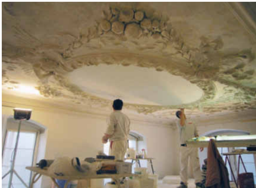
Des spécialistes en travaux de stuc et des restaurateurs ont travaillé pendant de longues semaines sur une plateforme de travail surélevée pour donner l'aspect d'aujourd'hui au plafond du deuxième étage.
