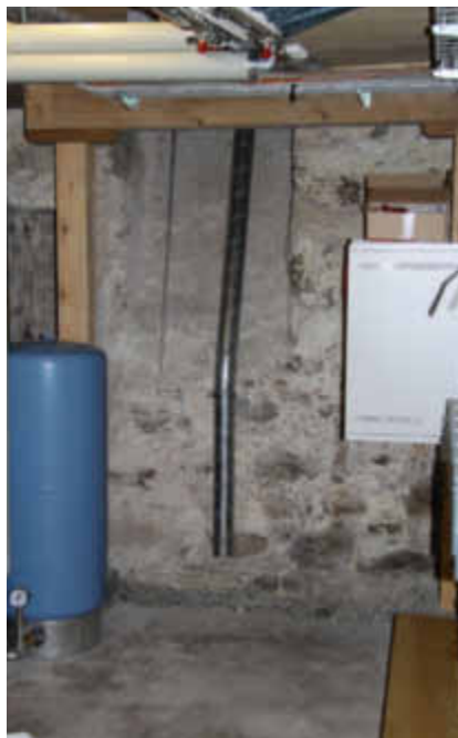
Des tirages naturels procurent une aération constante à la cave de la maison «Jauch».
