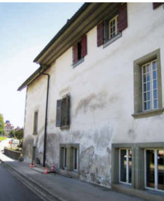
Ill. 3: Façade d'un bâtiment historique jouxtant une route cantonale à forte circulation. Le crépi s'effrite et des taches humides sont reconnaissables jusqu'à une hauteur élevée. La route est fortement salée en hiver et les déneigeuses ainsi que les poids lourds propulsent la neige chargée de sel jusqu'à plusieurs mètres de hauteur directement contre la façade. Les autres murs extérieurs du bâtiment sont complètement intacts.
